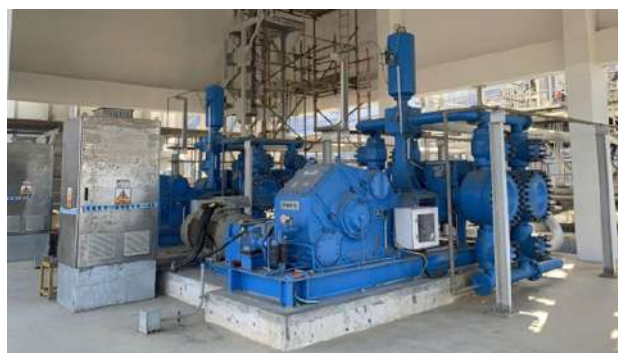
Hình 2: Hệ thống bơm bùn của nhà máy Nhiệt điện Vũng Áng 2
