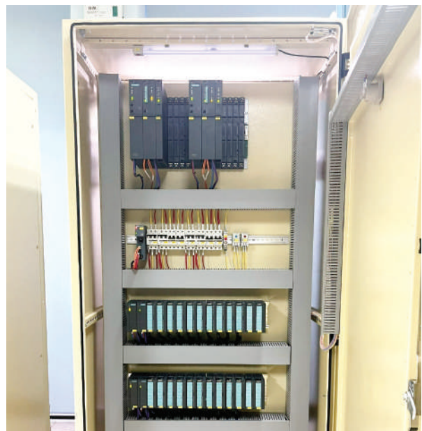
Hình 4. Hệ thống điều khiển PLC S7 412-5H cao cấp của Siemens
