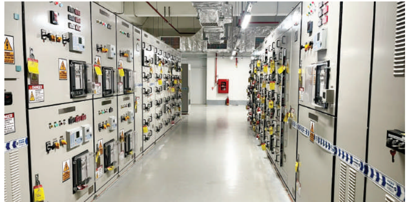
Hình 5. Hệ thống tủ điện động lực được lắp đặt tại Nhà máy Nhiệt điện Vũng Áng 2
