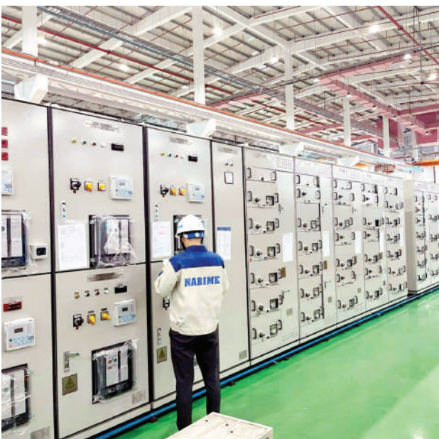
Hình 3. Nghiệm thu xuất xưởng hệ thống tủ điều khiển tại Nhà máy
